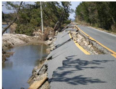
(写真左)いわき市内の海岸に近い道路は陥没している箇所もあり、通行止めとなっていました。
